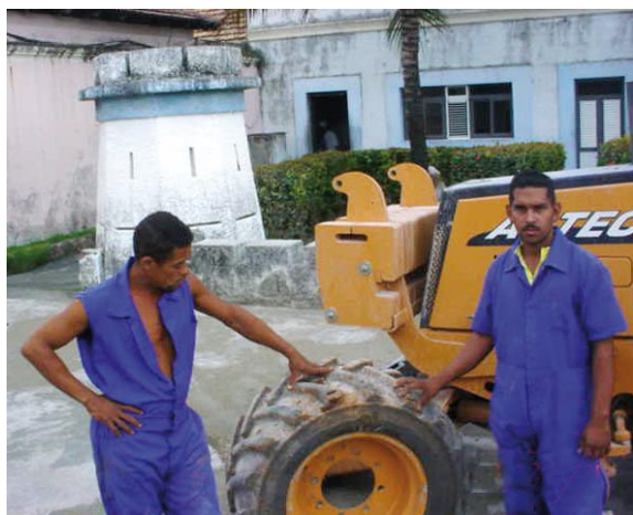
Alfredo Alba Socorro e Idel Ruiz Díaz (en la foto) con Yelina Serrano Elías forman un trío empeñado en asegurar la calidad en la construcción del acueducto de Baracoa.
