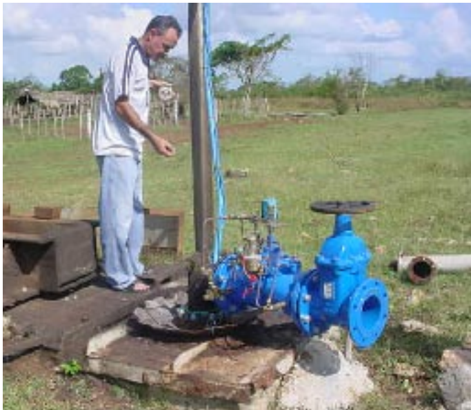
Uno de los autores de este trabajo observando el régimen de las aguas subterráneas.
