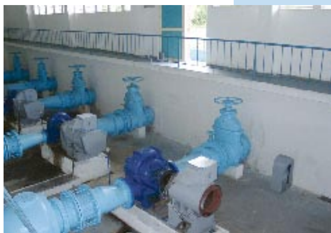
Fueron instalados 1 393 equipos de bombeo y 663 grupos electrógenos.
