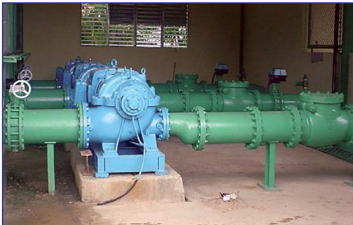
Fig. 3. Electrobombas horizontales conectadas en paralelo.
